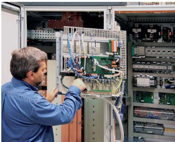
Qualitätsprüfung in der Umrichterfertigung.
